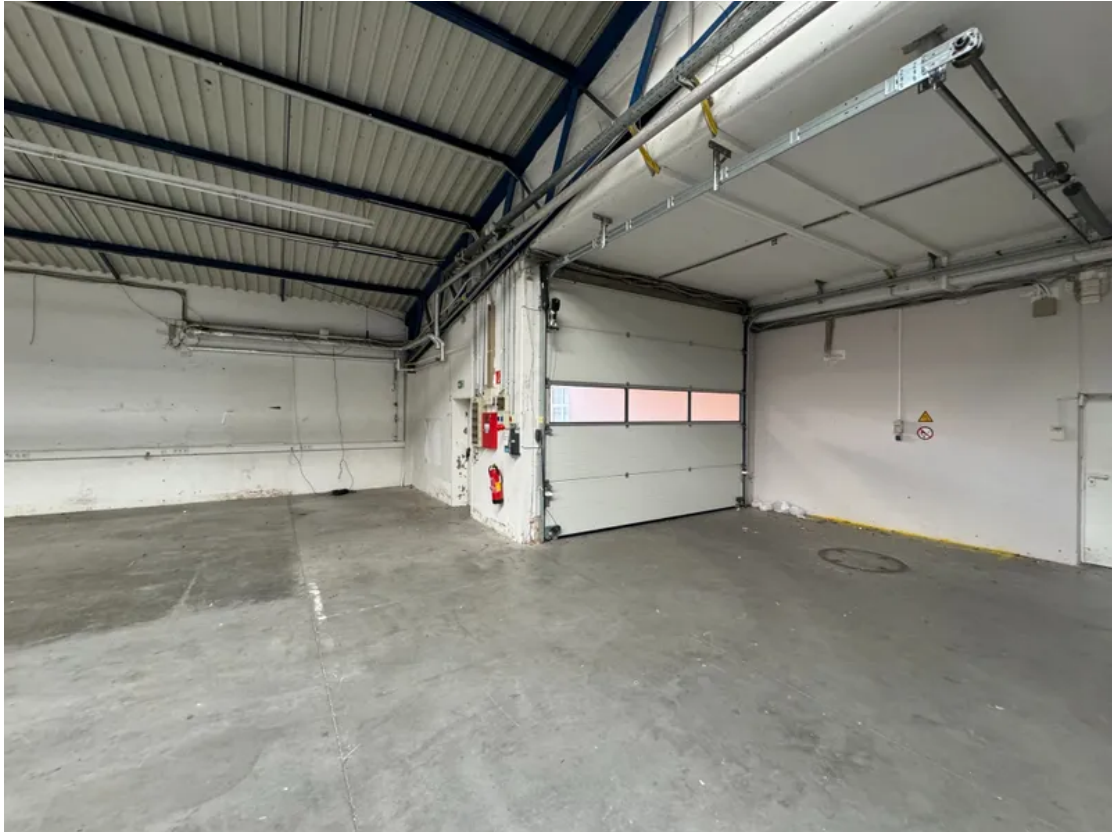
Rolltor Innenansicht Halle E
